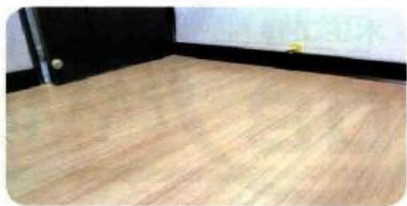
▲ 有的板材因四周伸缩缝不够大，加上板材间又是无缝的接法，会造成木板无法热胀冷缩，而造成声响或起拱。
