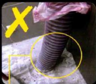
▲ 软管易破，别当补救材 用软管塞进排粪管作为补救的 方法，日后漏水几率相当高。
